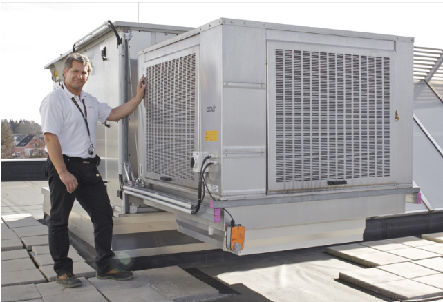
Udo Bär von der Gealan Formteile GmbH hat den Prototyp einer Klimaanlage auf Basis der adiabatischen Kühlung mit entwickelt. Sie sorgt in einer Produktionshalle für Spritzgussteile für angenehmes Arbeitsklima. Fotos: bgrci/Plöger
