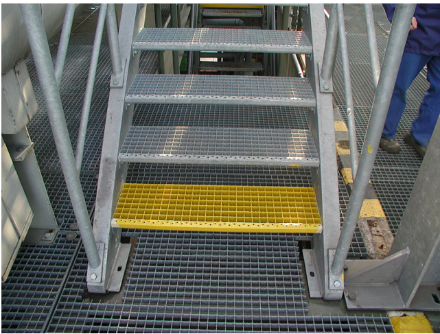
Gitterrosttreppen mit Signalfarben unten
